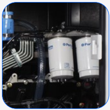
Filtro separador de partículas de combustible
