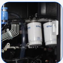
Filtro separador de partículas de combustible
