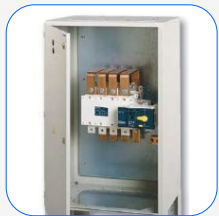
Cuadro de conmutación motorizada Socomec
