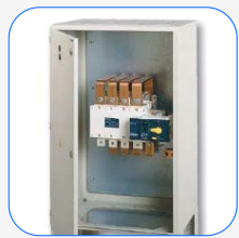
Cuadro de conmutación motorizada Socomec
