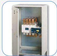
Cuadro de conmutación motorizada Socomec
