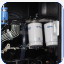
Filtro separador de partículas de combustible
