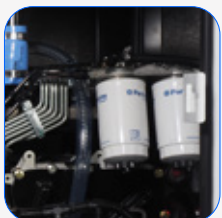
Filtro separador de partículas de combustible
