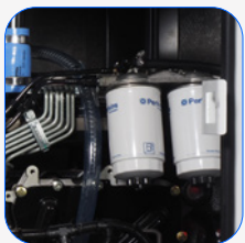
Filtro separador de partículas de combustible
