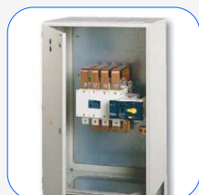
Cuadro de conmutación motorizada Socomec
